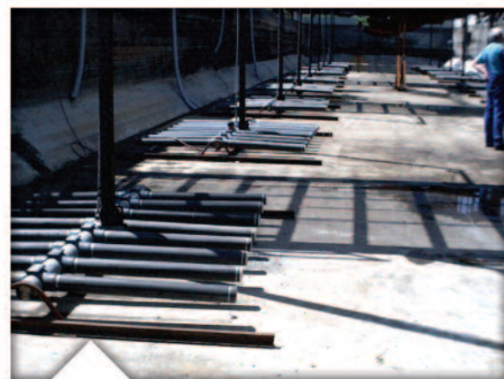
Te drobnopęcherzykowe unoszone ruszty rurowe na przewodnicach szynowych działają od 10 lat na miejskiej oczyszczalni ścieków.
